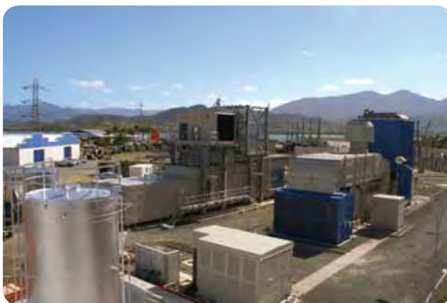
Nouvelle-Calédonie : Turbine électrique d'Enercal à Ducos
