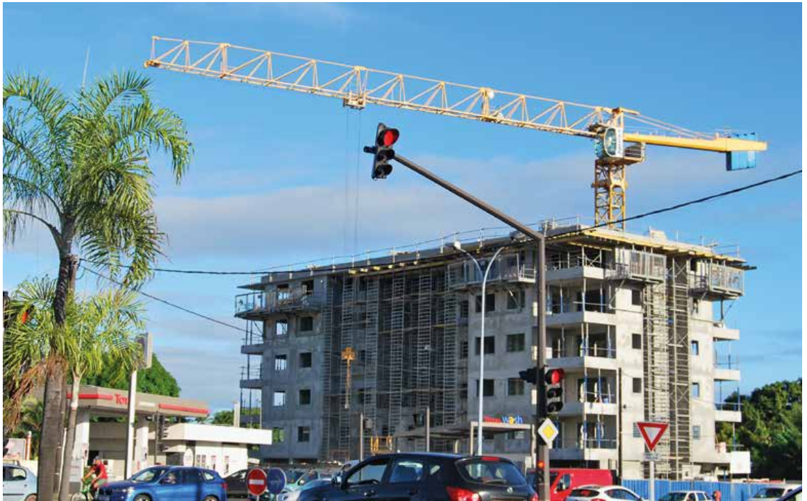
Polynésie française (Tahiti). Résidence de logements en location-acquisition à Fariipiti, ville de Papeete. © Office Polynésien de l'Habitat (OPH)
