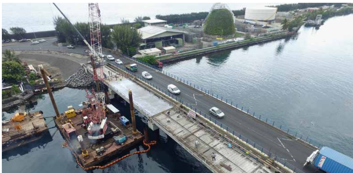
Polynésie française (Tahiti). Vue aérienne du chantier de construction du pont poids lourds à Motu Uta, ville de Papeete. © Port autonome de Papeete
