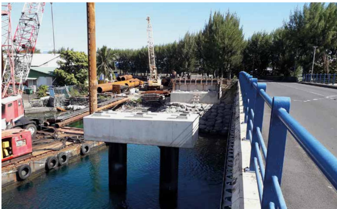
Polynésie française (Tahiti). Chantier de construction d'un pont poids lourds (jusqu'à 75 tonnes) à Motu Uta, ville de Papeete. © Port autonome de Papeete
