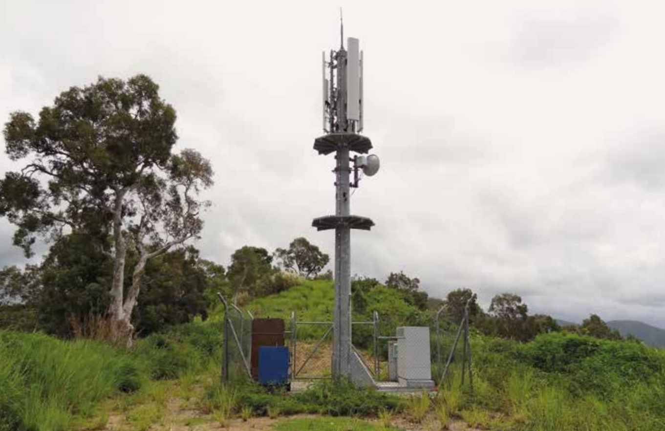
Nouvelle-Calédonie. Antenne-relais mobile. © OPT-NC
