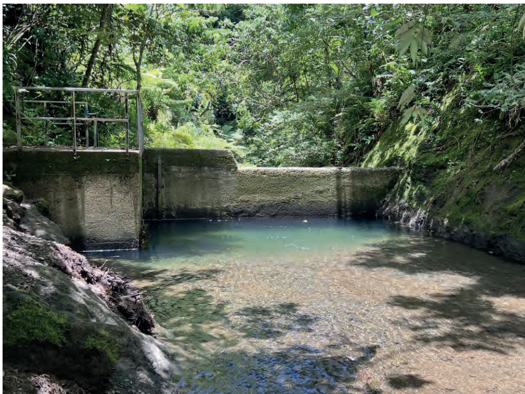
La centrale hydroélectrique de Vainifao à Futuna, d'une puissance de 200 kW
