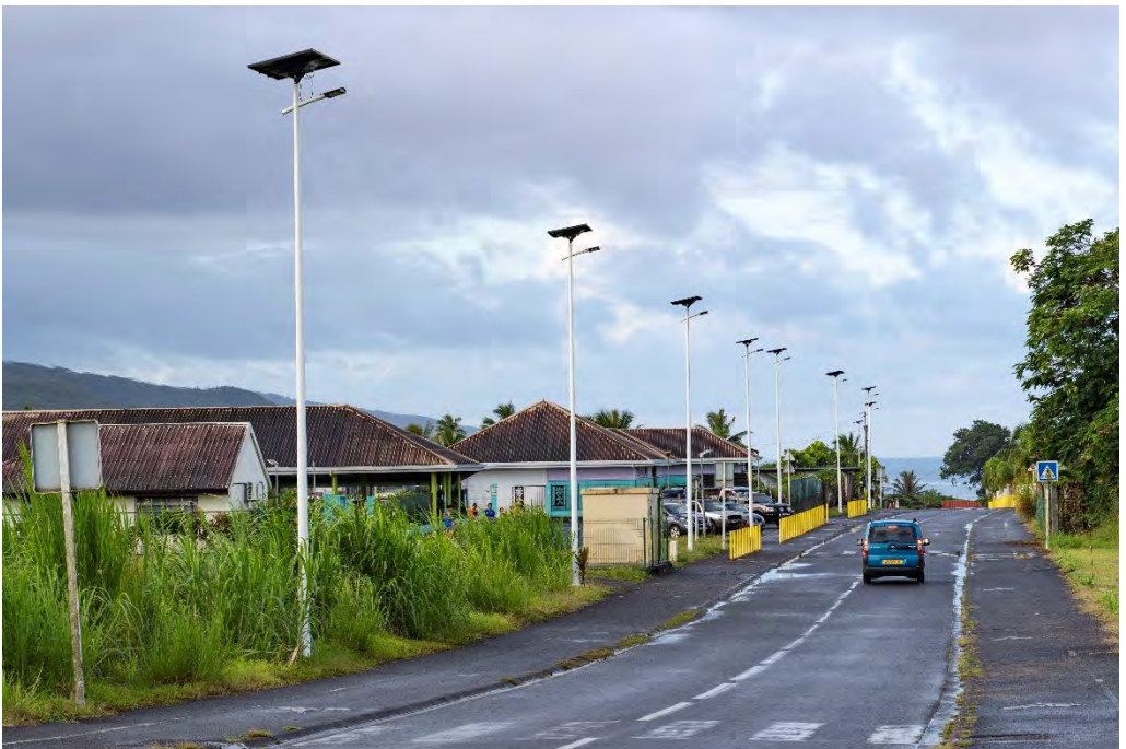
Lampadaires solaires à Tairapu-Est (île de Tahiti) © Mathias CLEMENT, photographie pour l'Agence française de développement
