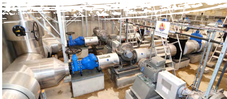
Centre technique du SWAC du Centre hospitalier de Polynésie française (CHPF) qui assure la climatisation de l'hôpital © Présidence de la Polynésie française
