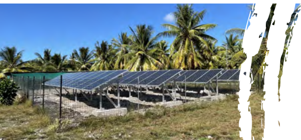
Ferme perlière sur l'atoll d'Ahe en site isolé alimentée par une centrale photovoltaïque en Polynésie française © SARL Conexun
